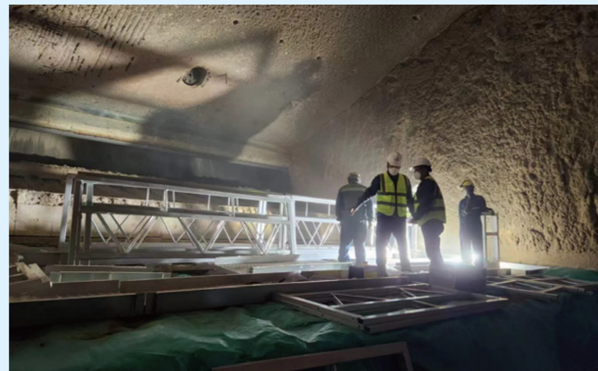
中际联合、中科环保、中科绵投现场负责人,现场实操进行过程监管,安全完成多次上下行及部分检修工作测试。
